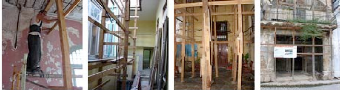
Restauraciones y acciones emergentes con el apoyo de la cooperación internacional, para frenar el deterioro del fondo edificado y preservar las vidas de sus habitantes (Edificios Barcelona 63, Cárdenas 103, Paula 205 y San Ignacio 360)
